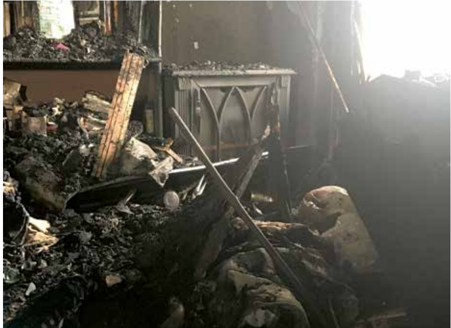
Schwere Schäden nach dem Wohnungsbrand in der Steinstraße 3: Die betroffene Wohnung ist unbewohnbar. Der Wiederaufbau wird einige Zeit in Anspruch nehmen, doch die Genossenschaft arbeitet an Lösungen für alle betroffenen Mieter.
